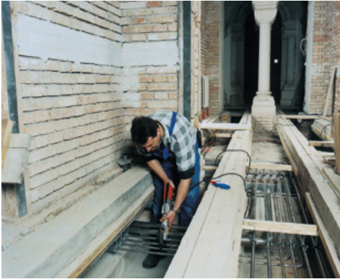
Nelle operazioni di ammodernamento degli impianti di riscaldamento di edifici storici, i vantaggi del metodo a freddo, che non comporta rischi di incendio, sono notevoli. Foto: Geberit, Jona (CH)
